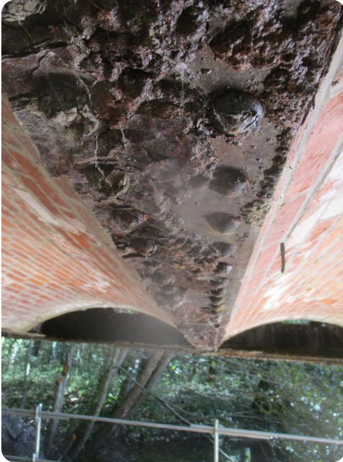
Intrados d'un ouvrage : voûtaines dégradées et structure métallique corrodée
